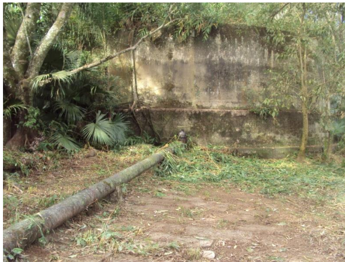
Figura 6 – Tanque de óleo combustível.
