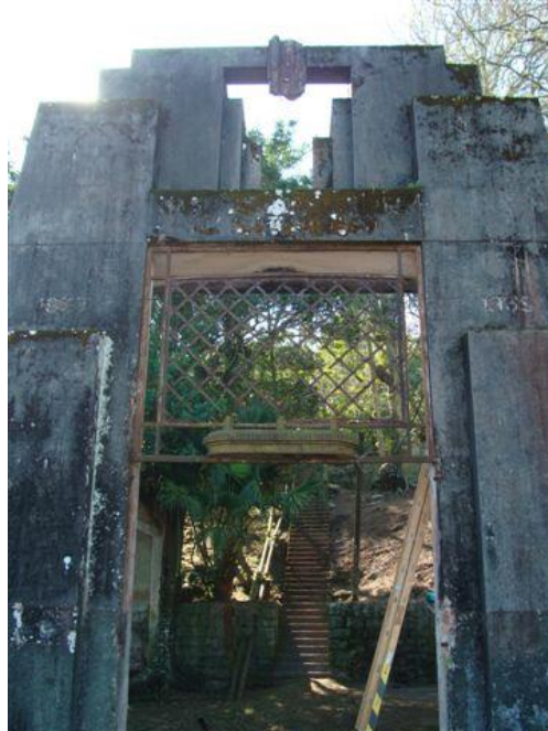
Figura 11 – Pórtico da base, início da Escadaria, e ao lado tubos de água.
